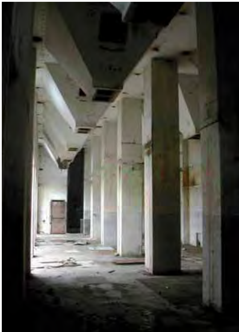
ACM complex Groningen, interieur grondstoffendoseersilo
