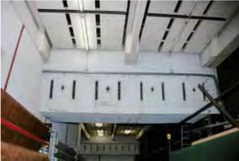
Van Heekcomplex Enchede, ventilatiekanaal weverij
