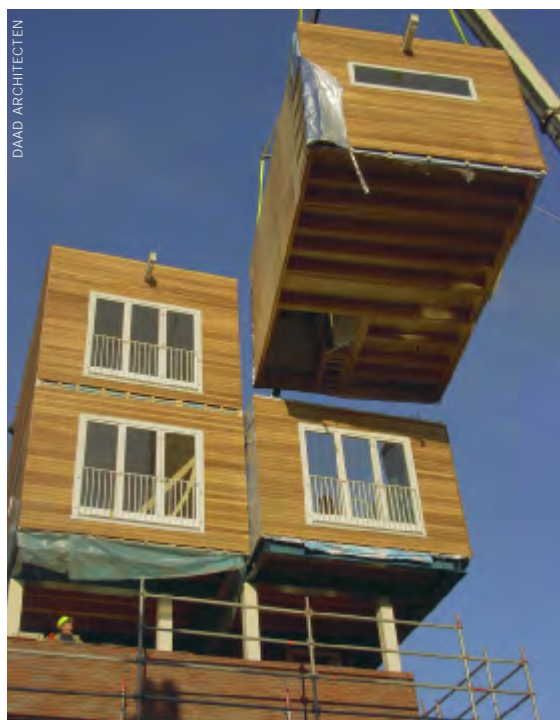
Plaatsing van de modules gebeurt met een kraan waardoor steigers niet nodig zijn.
